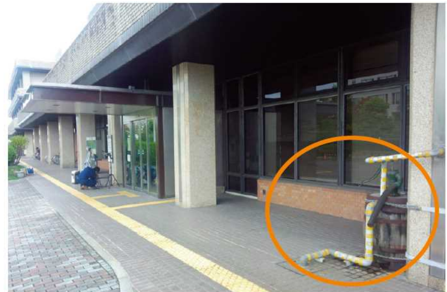
▲滋賀県南部総合庁舎(草津市) 玄関にも雨水貯留タンクを設置しています
