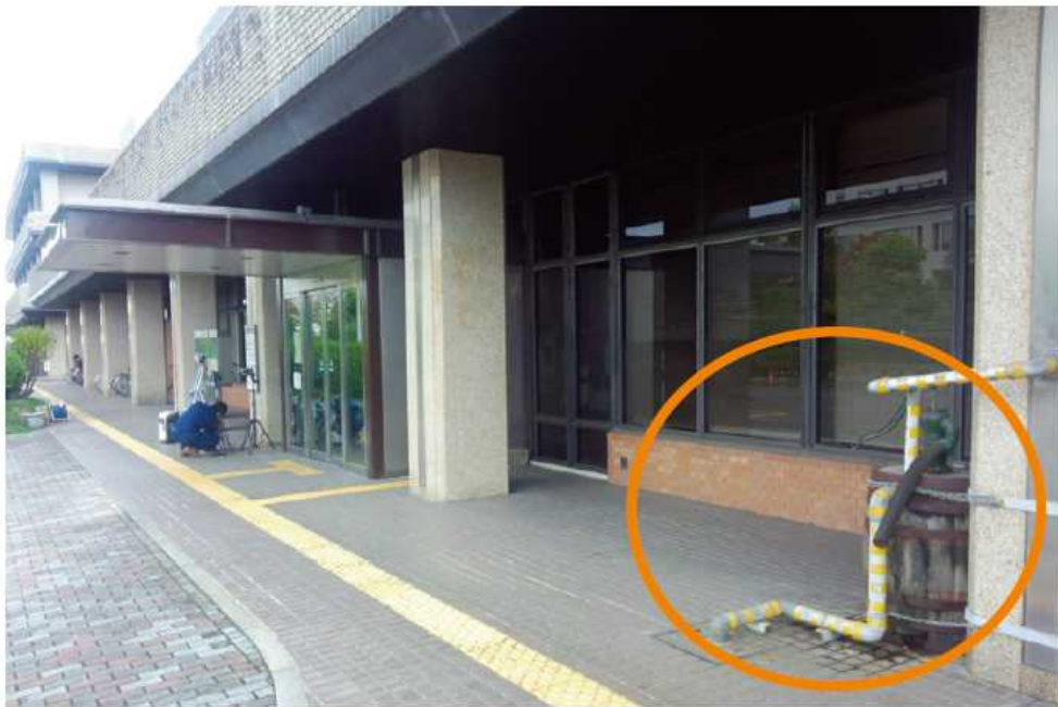
▲滋賀県南部総合庁舎(草津市) 玄関にも雨水貯留タンクを設置しています
