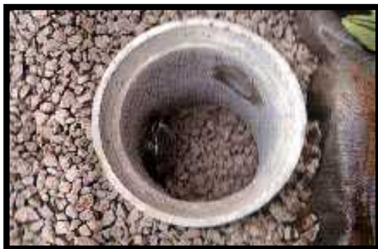
雨水浸透ます
