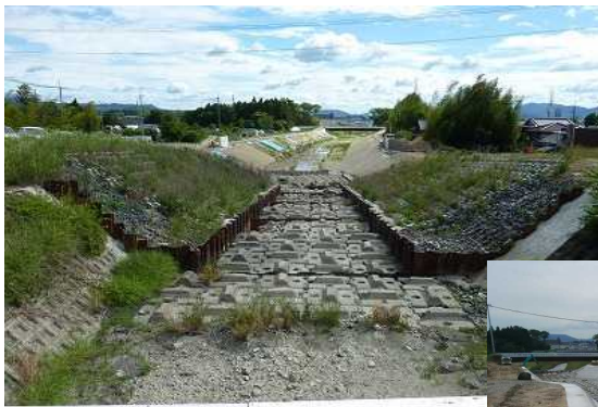
金勝川被災前写真
