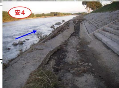
本庄橋上流約1.8km 右岸 張ブロック護岸欠損 L=61.5m
