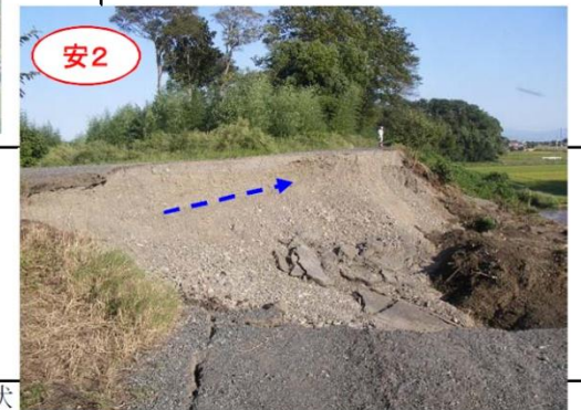
本庄橋上流約1.5km 右岸 堤防法面欠損(堤内) L=58.5m
