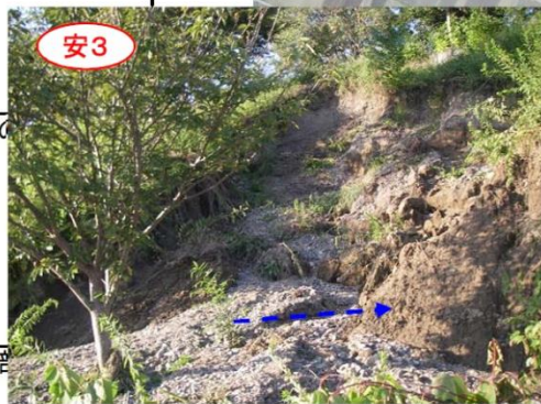
161号線下流約1.8km 右岸 堤防法面欠損(堤内) L=9.5m
