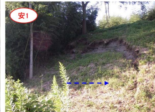
本庄橋上流約1.0km 右岸 堤防法面欠損(堤内) L=22.0m
