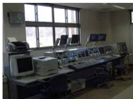
コントロール室
