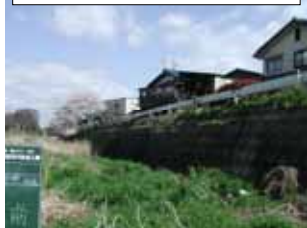
護岸の膨らみ
