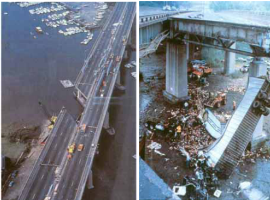
マイアナス橋の落橋
