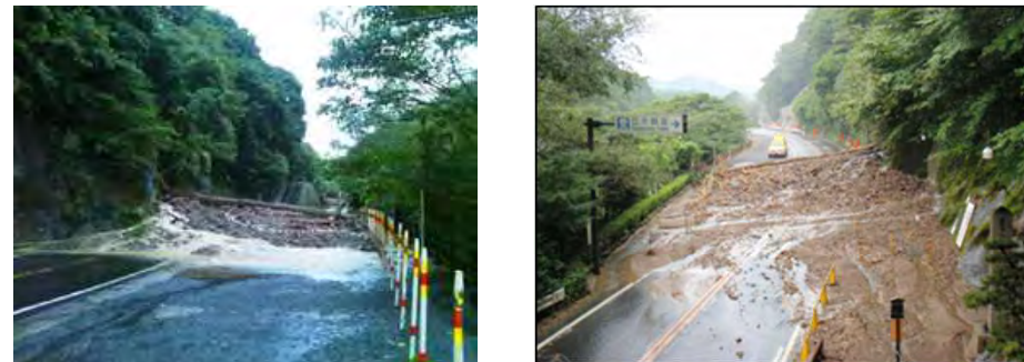
H24.8.14 大津南部集中豪雨時被災状況
