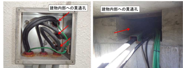
図-6 外壁に設置されているプルボックス内部（左）、電気ハンドホール内部（右）
