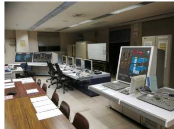
図-5 東北部浄化センター中央監視室
