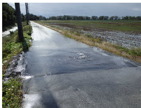
写真-2 マンホールからの溢水状況その2
