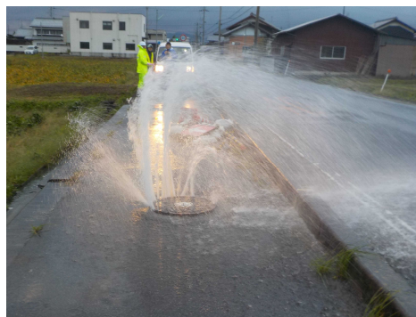
写真-1 マンホールからの溢水状況その1
