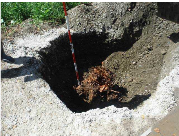
写真-2 堤体内に残留した切り株
