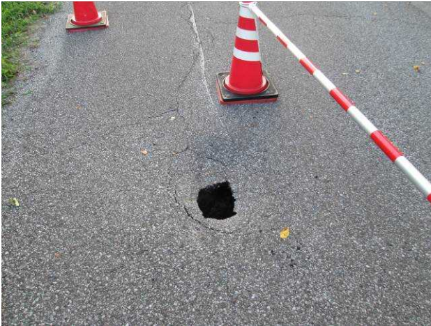
写真-1 陥没状況写真
