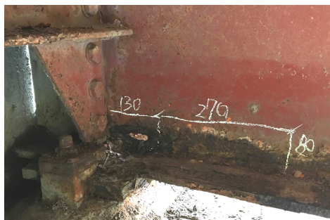
写真-1 桁端部の鋼部材腐食状況
