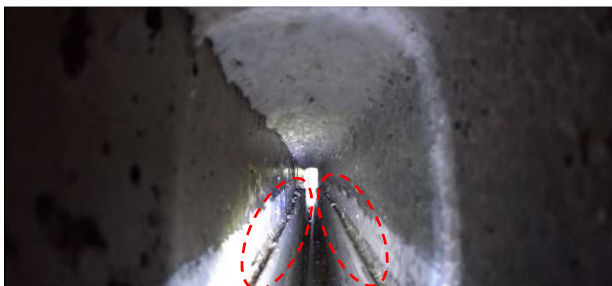
写真-9 止水材の縁切れ状況（赤破線）
