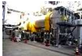
写真-1 汚泥乾燥機
