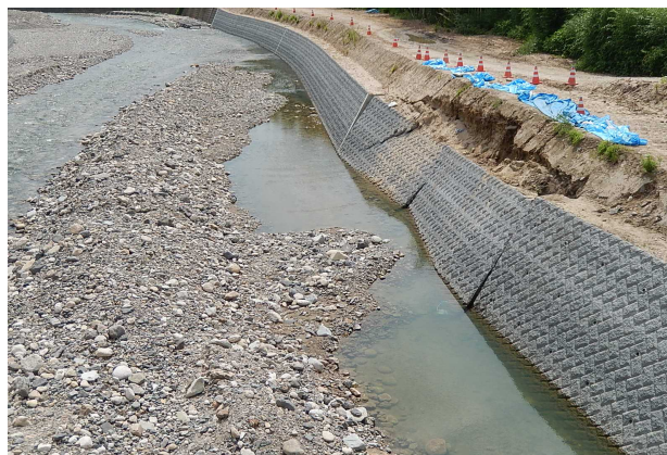
図 - 19 施工済区間における被災状況
