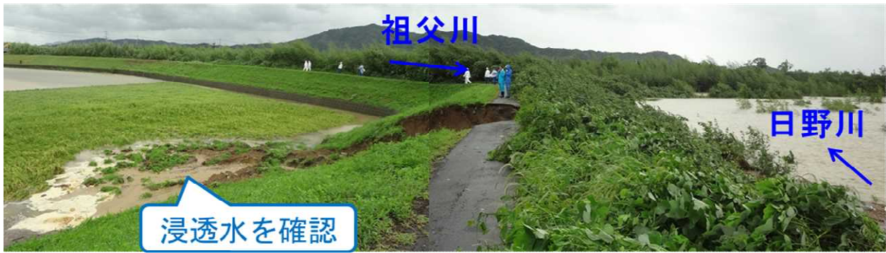
図-8 崩壊直後の状況
