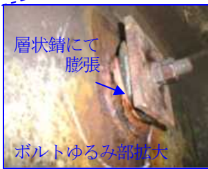
写真-8 主桁腐食部
