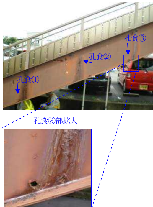
写真-6 階段部腐食
