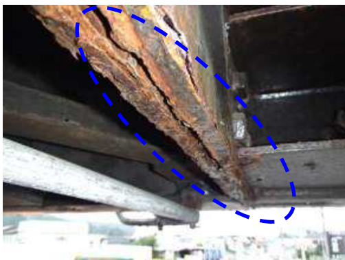
写真-9 横桁腐食部
