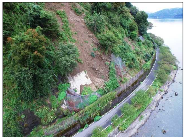
写真-2 県道西浅井マキノ線 道路法面崩落現場 (高島市マキノ町地先)
