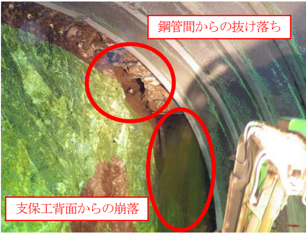
図 - 7 切羽肩付近からの崩落
