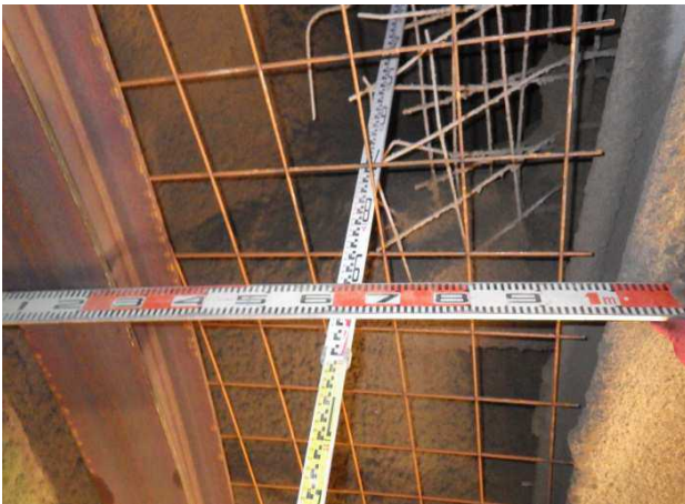
図 - 8 鋼管間からの抜け落ち (約4m)
