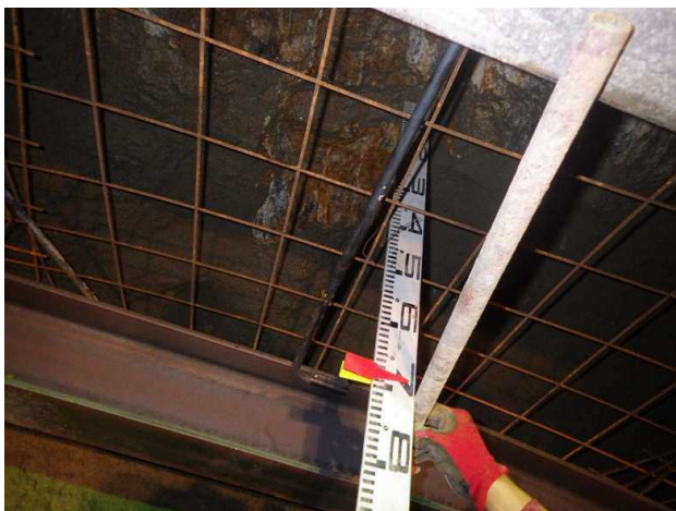
図-5 天端鋼管下部からの剥落 (t=700mm)
